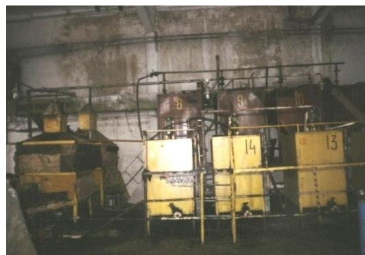
Рисунок 7 – Производственная установка регенерации отработанных трансмиссионных масел
