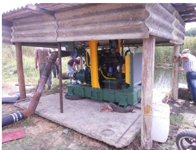
Рисунок 27 – Дизельная насосная станция ДНС-К-140-130
